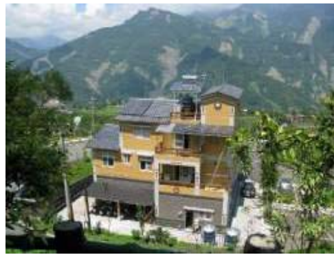
3.2 kWp solar array
